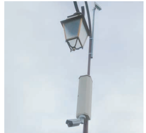
7 caméras de vidéo protection sont installées.
